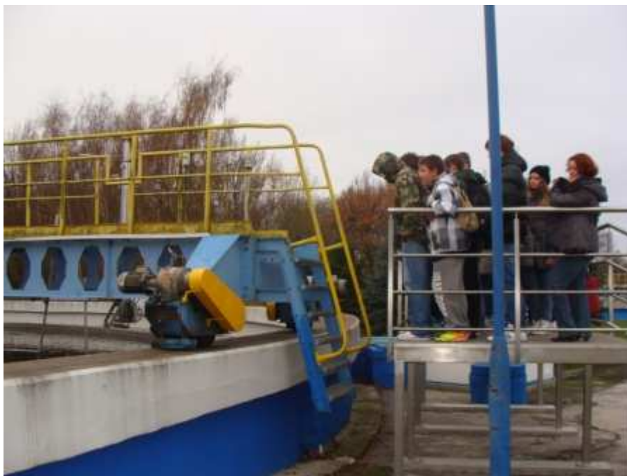
W Oczyszczalni Ścieków ( etap biologiczny )
